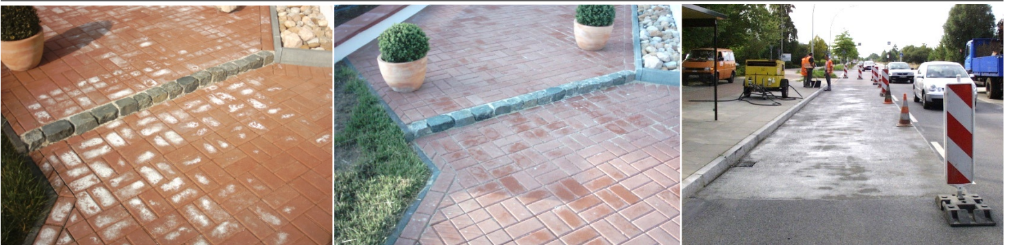
Ausblühungen an roten Betonstein beseitigt (vorher – nachher) / eine von mehreren Busspuren STRABAG HH
